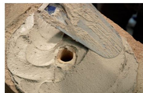
4 Realizzazione e preparazione del foro previsto per l'installazione del connettore a fiocco.
