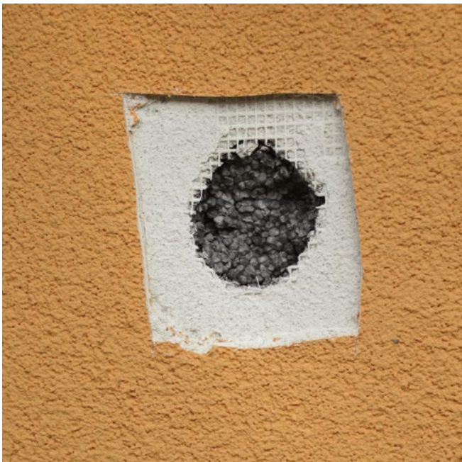
Danno accidentale esteso al pannello isolante
