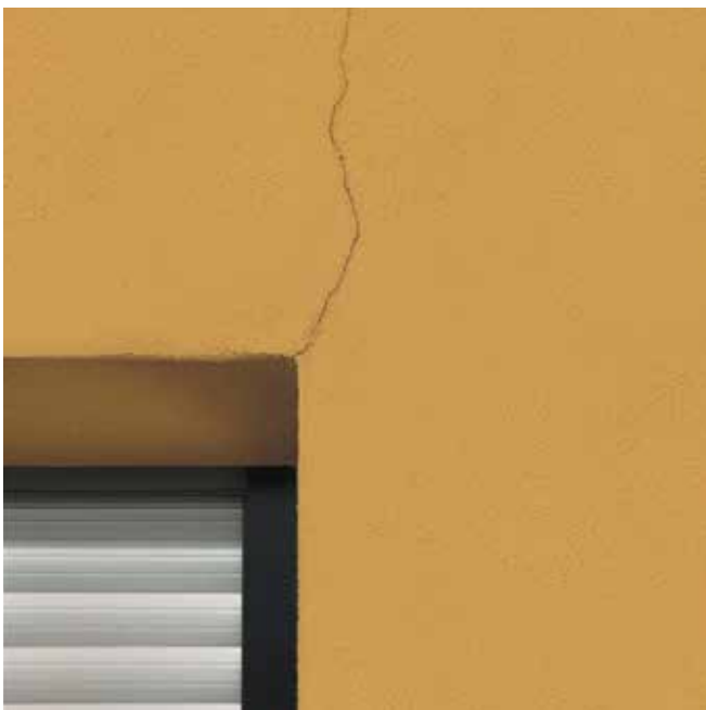
Ρηγματώσεις στην άκρη του ανοίγματος
