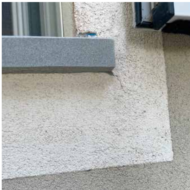
Ρωγμές κοντά στο περβάζι παραθύρου
