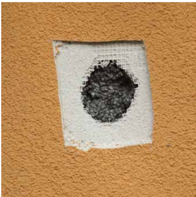
Ζημιά εκτεινόμενη στο θερμομονωτικό πάνελ
