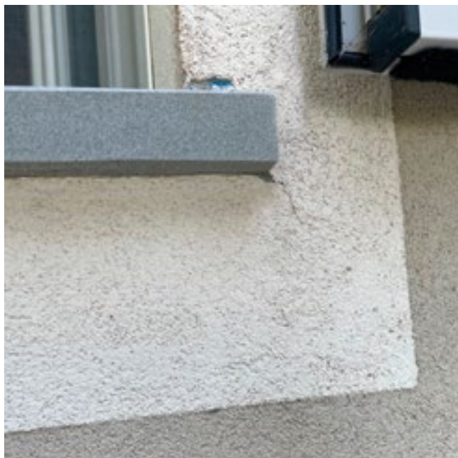
Cavillatura in prossimità del davanzale
