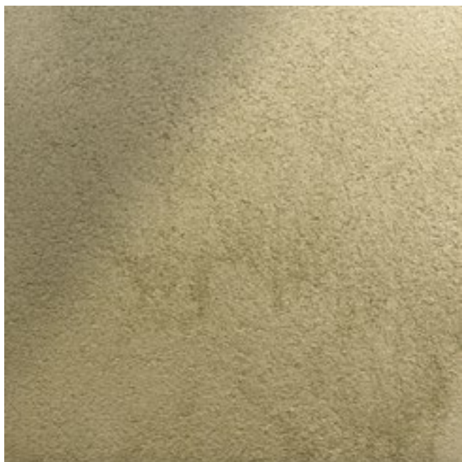
Superficie con depositi e muffe
