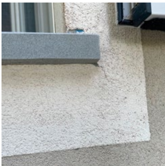
Craquelure à proximité de l'appui de fenêtre
