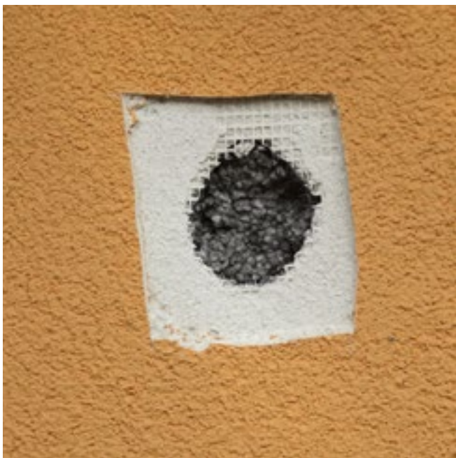
Dommages accidentels étendus au panneau isolant
