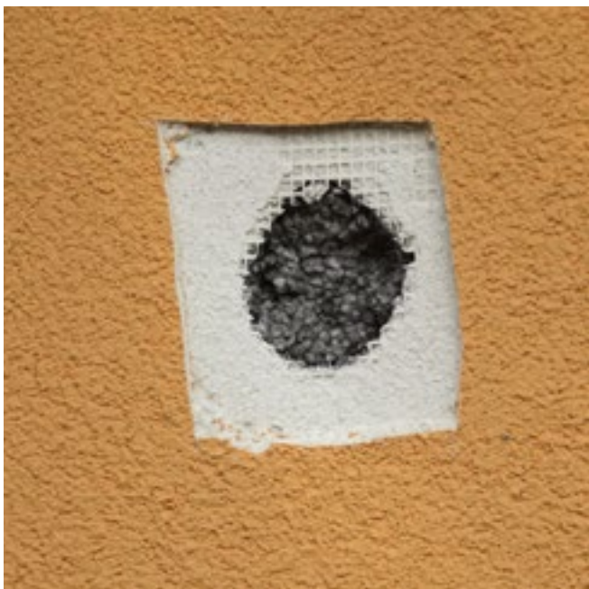
Unfallschaden, der sich auf die Dämmplatte erstreckt
