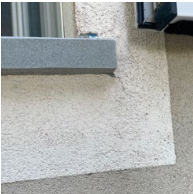
Feine Rissbildung in der Nähe des Fensterbretts
