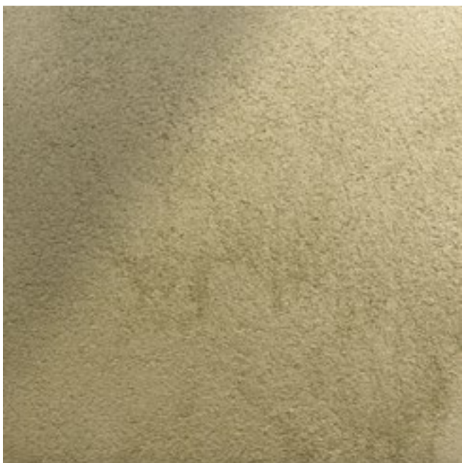
Oberfläche mit Ablagerungen und Schimmel
