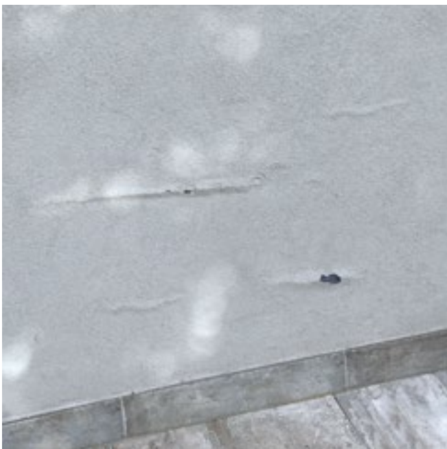
Ablösung der oberflächlichen Schichten in der Nähe der GOK
