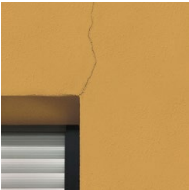
Rissbildung an den Eckbereichen der Öffnung
